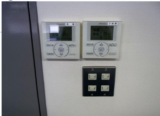
出入口A扉横個別空調リモコン
